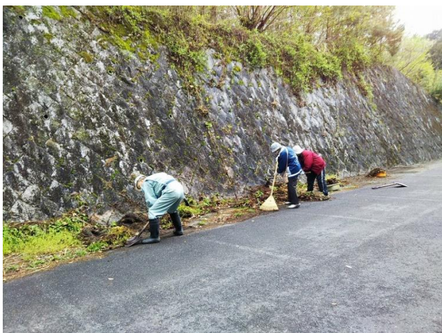
駐車場奥の石垣の下、たまった泥、草の処分
